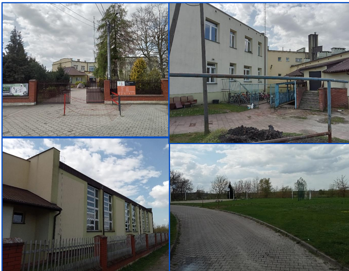
Ryc. 14. Stan techniczny budynku Szkoły Podstawowej im. Fryderyka Chopina w Brochowie oraz obiektów tworzących przestrzeń rekreacyjną w jej sąsiedztwie
