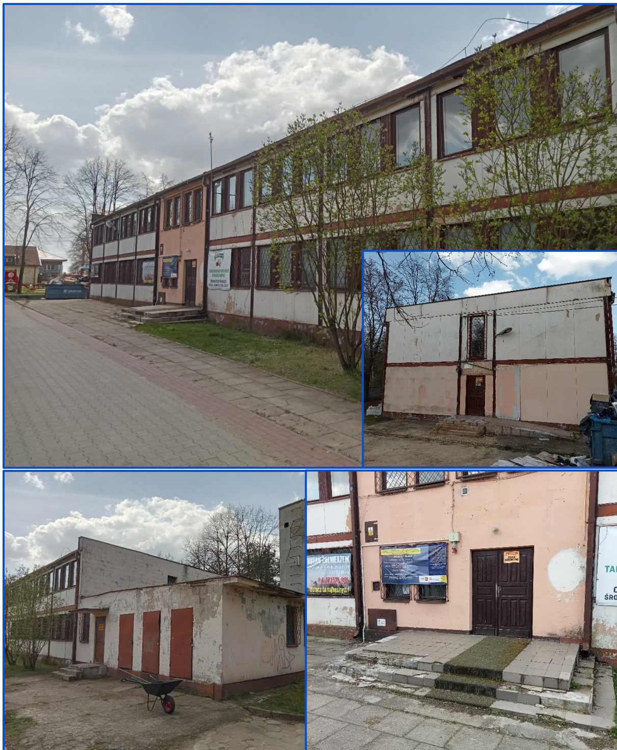
Ryc. 17. Stan techniczny dawnego budynku administracyjnego – dawnego Urzędu Gminy w Brochowie
