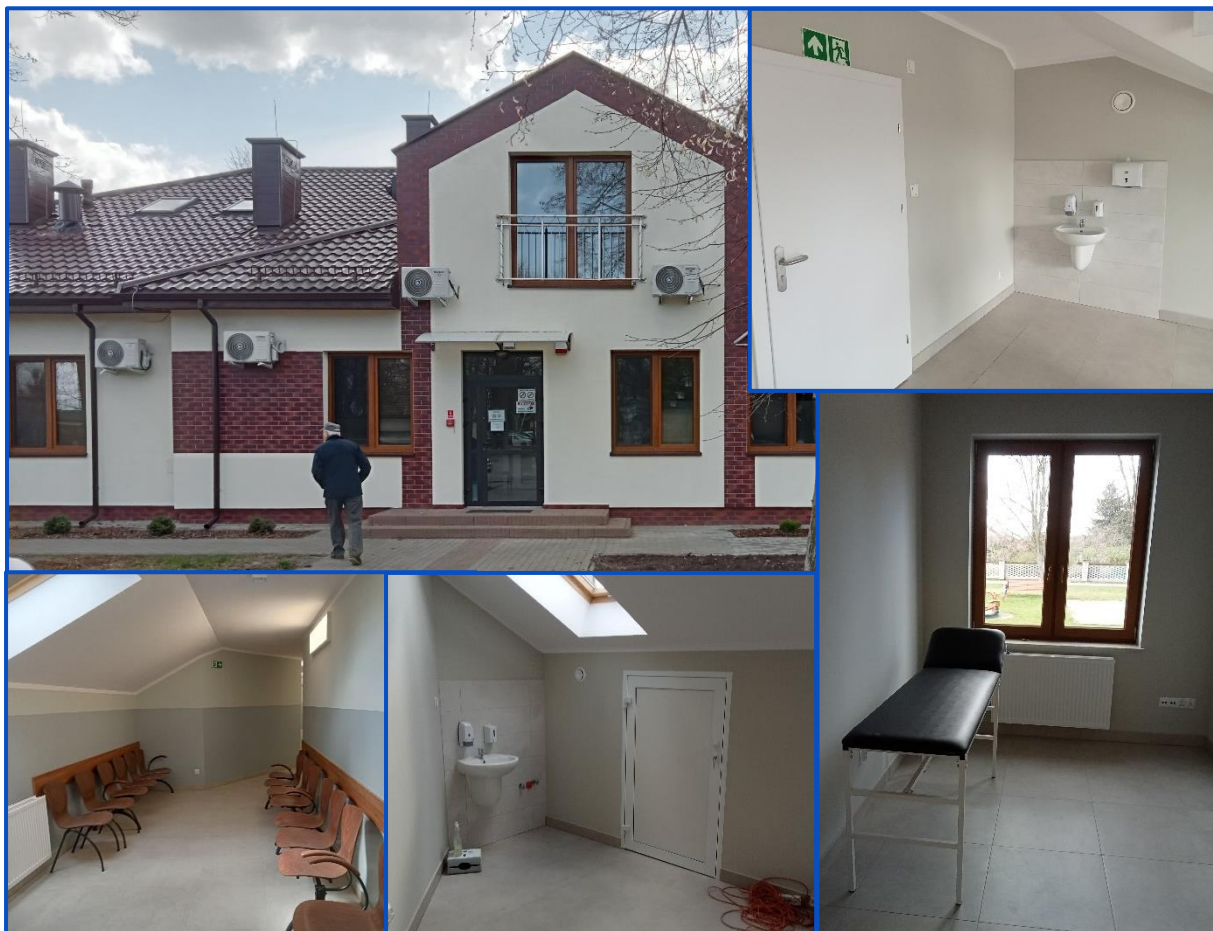
Ryc. 15. Stan techniczny budynku Gminnego Centrum Medyczo-Rehabilitacyjnego w Brochowie
